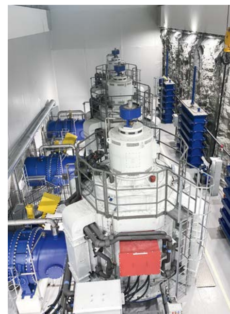
Usina geradora de Tolga. A nova usina elétrica de fio de água está equipada com três turbinas Francis compactas de 15 MW idênticas.
