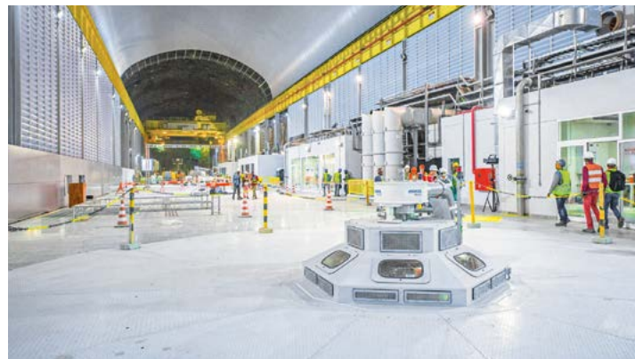
A usina geradora principal tem mais de 270 m de comprimento e inclui seis unidades cada com uma potência nominal de 335 MW.
