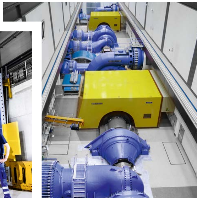
Com quatro unidades geradoras, Wehr é a maior usina elétrica no portfólio da Schluchseewerk AG e fornece serviços de equilíbrio da rede.
